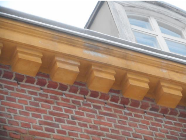
Kuva 40, betoni/ tiilirakenteinen räystääs ulkoisesti kohtalaisessa kunnossa, iän ja mahdollisen pakkarapauman myötä suositellaan kuntotutkimuksen tekemistä
