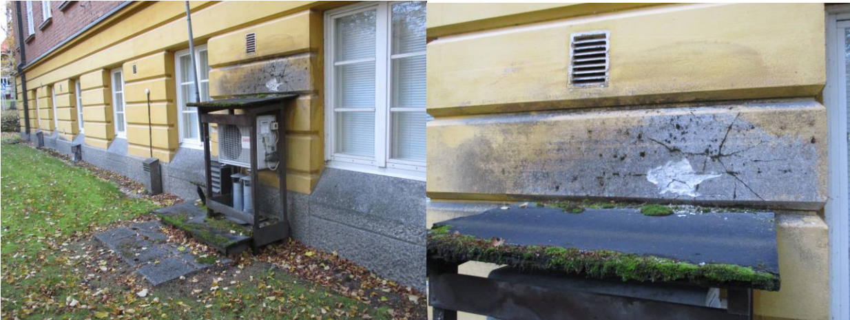
Kuvat 15-16, Ilmalämpöpumpun katoksesta roiskuva vesi rapauttaa seinärappausta
