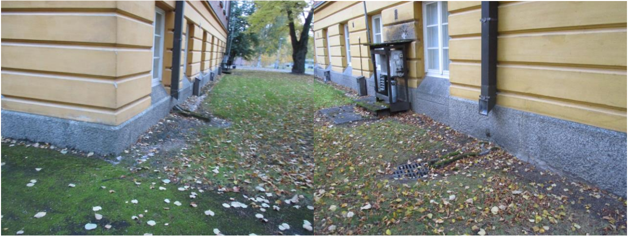
Kuvat 5-6, kostea multamaa rakennuksen sokkelissa/perusmuureissa kiinni
