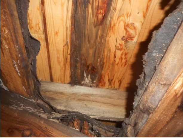
Kuva 39, Edellisessä kattoremontissa uusitussa ruoteessa on myös kosteusjälkiä
