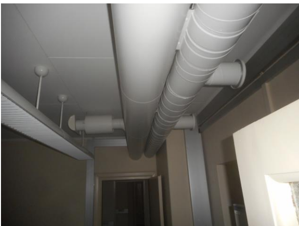
Kuva 67, 3.kerroksen tulo- ja poistoilmakanavia
