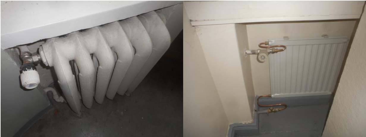
Kuva 60, Patterit iäkkäitä, termostaattiventtiilit n. 25 vuoden ikäisiä
