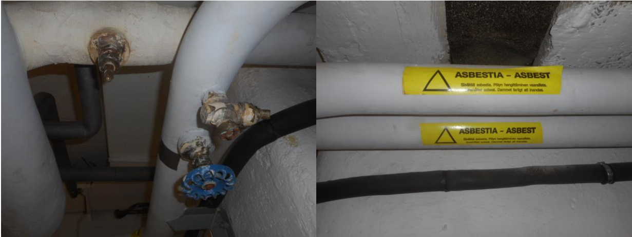
Kuva 58-59, lämpöjohtojen venttiilit iäkkäitä, eristeissä asbestia
