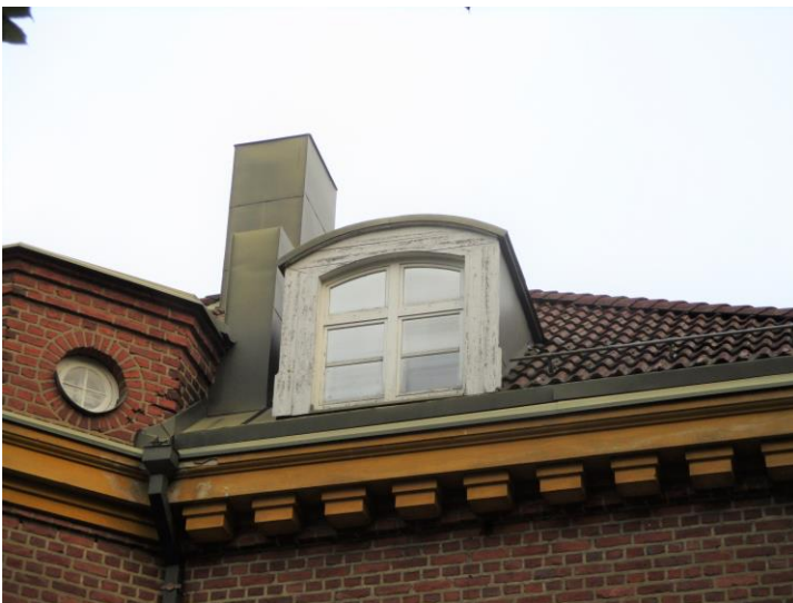
Kuva 22, tiilirak. ”tornissa” tiilisauman rapaamaa, räystäässä kosteusjälkiä
