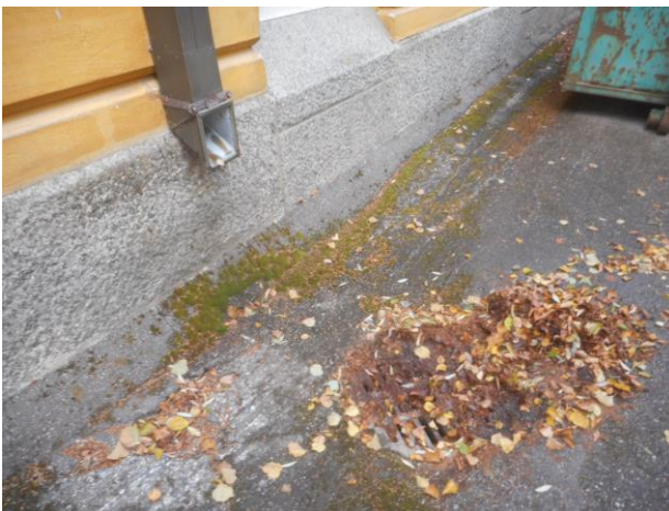
Kuva 4, tien puolen päädyssä maanpinnat viettävät rakennusta kohden, kattosadevedet kastelevat sokkeliä ja pintavesikaivon vetoisuus heikko
