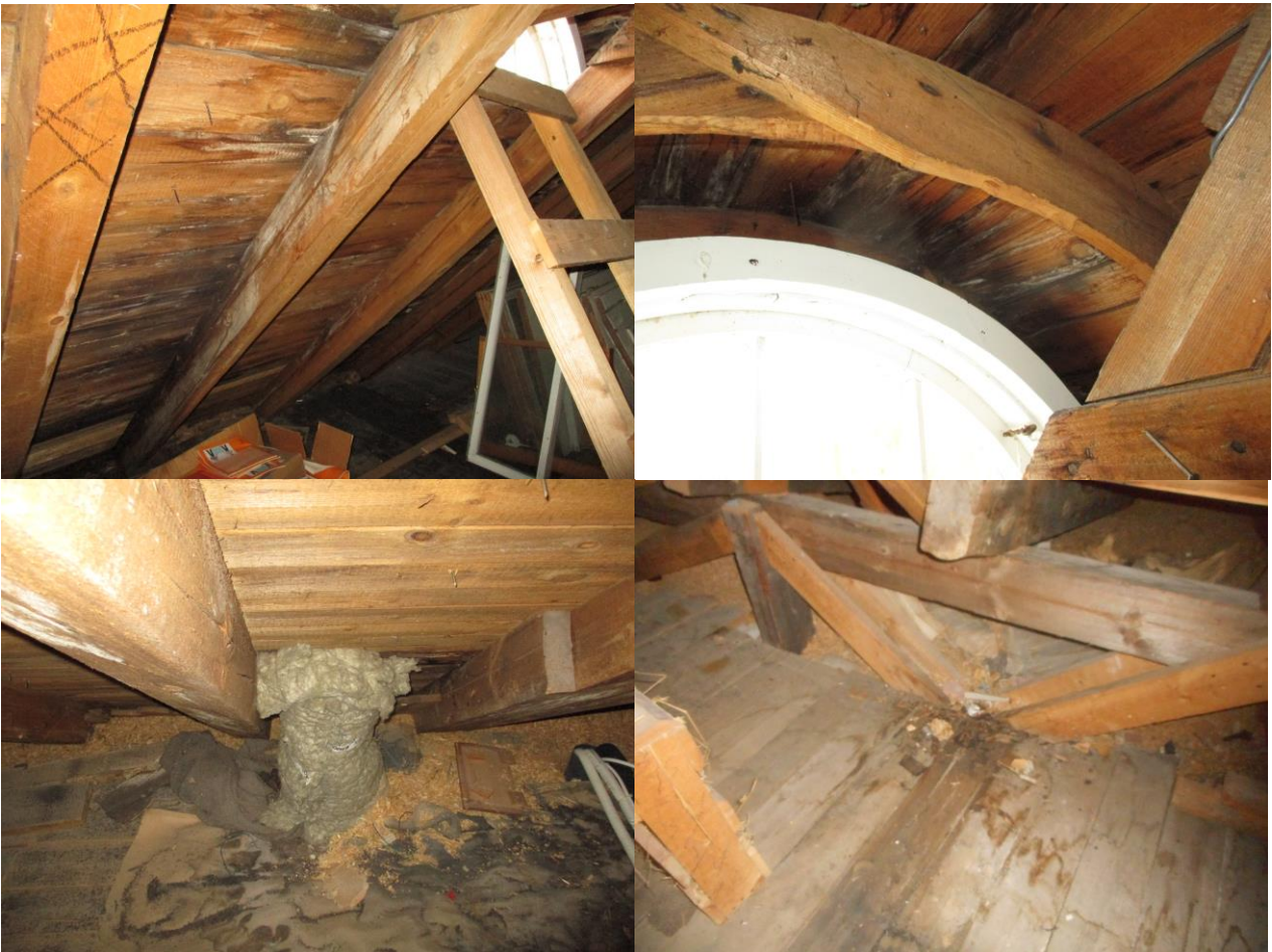
Kuvat 35-38, yläpohjassa oli lukuisia vesivuotojälkiä
