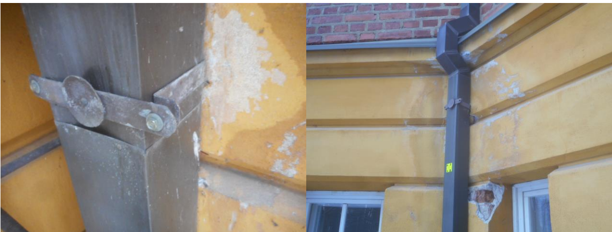
Kuvat 19-20, syöksytörvien epätiivisyys aiheuttanut kosteusvaurioita julkisivuun
