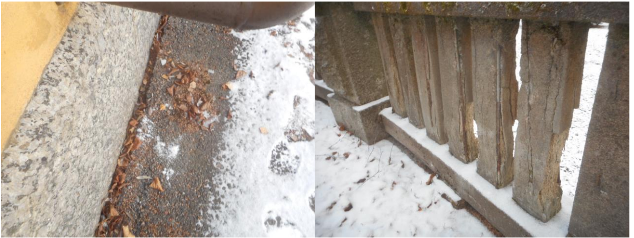
Kuva 7, asfaltti irronnut rakennuksesta
