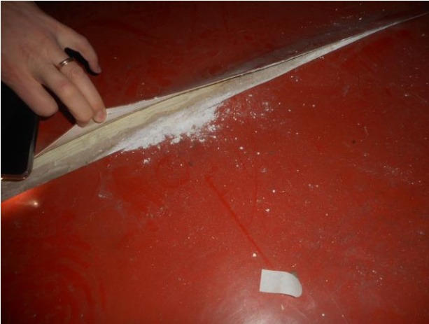
Kuva 42, muovimatton saumasta puskeva kalkkihärme kertoo merkittävästi koholla olevasta alustan kosteudesta
