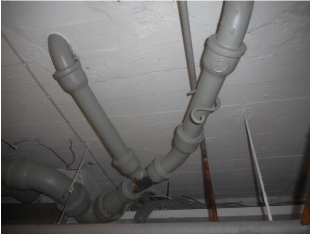
Kuva 64, valurautaviemärin hajotuksia kellarin alakatossa
