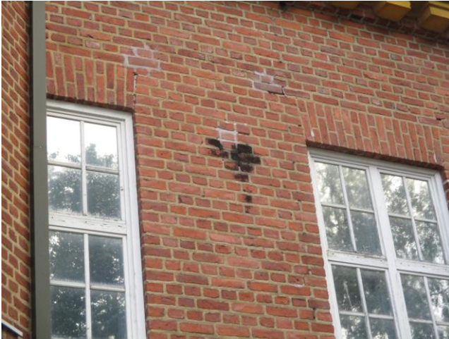
Kuva 21, julkisivussa likaa ja epätasavärisiä laastipaikkauksia
