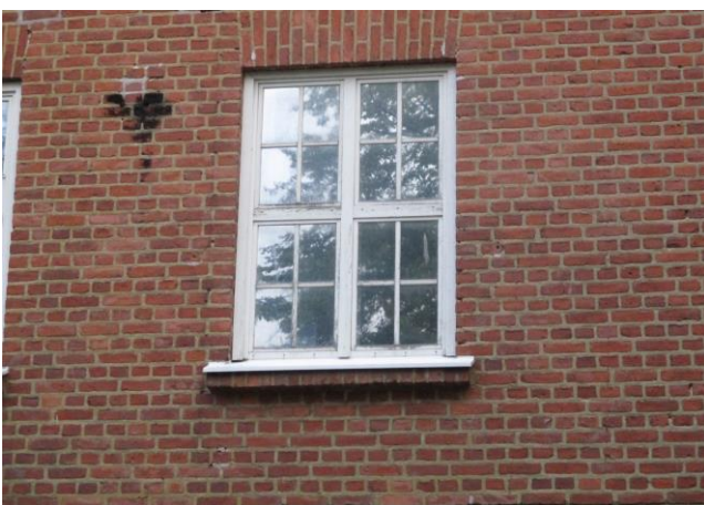
Kuva 23, Etenkin 2. ja 3. kerroksen ikkunoissa on ulkopuitteiden huoltomaalaustarvetta
