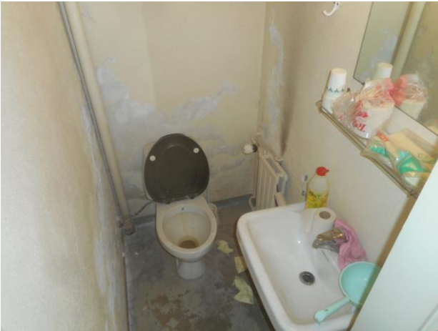
Kuva 43, pohjakerroksen wc ja suihkutila heikkokuntoinen
