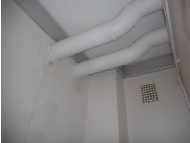
Kuva 69, IV-kanavien seinäläpiviennissä kosteusjälkiä
