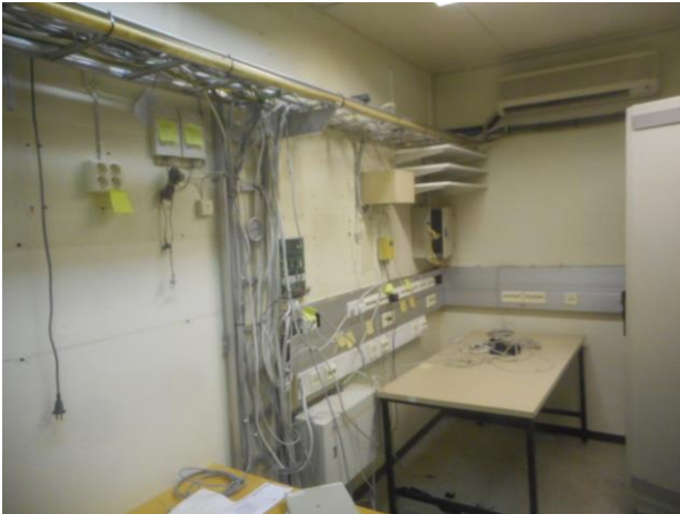
Kuva 70, Pohjakerroksessa paljon tarpeettomaksi jääneitä johtoasennuksia
