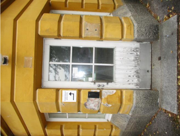
Kuva 29, päädyn ulko-ovi oli ulko-osiltaan heikommassa kunnossa
