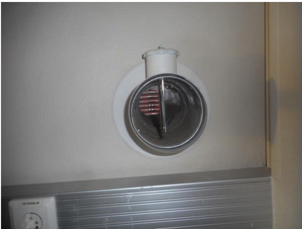
Kuva 66, etenkin 1.kerroksen ulkoseiniin on porattu paljon jälkikäteen korvausilmaventtiileitä
