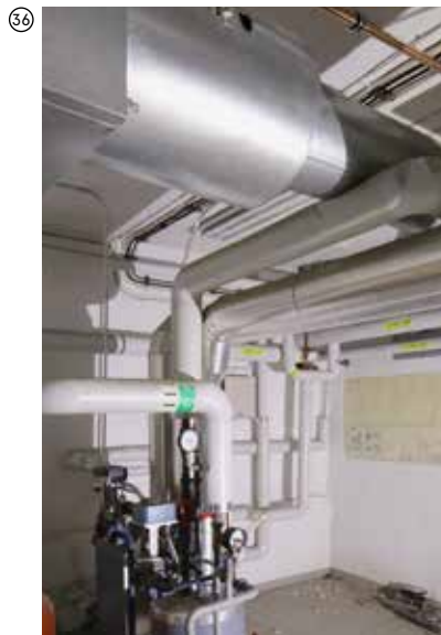
↑ Kellariin on sijoitettu talotekniikkaa.
