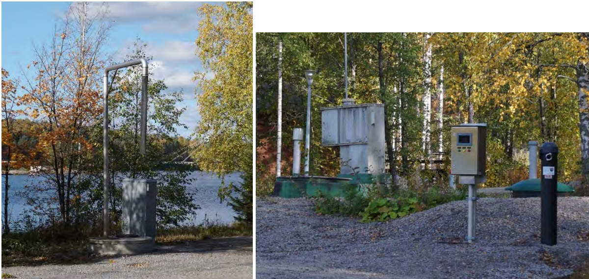
Kuva. Palomäenkadun päässä sijaitseva vesipiste ja pumppaamo.
