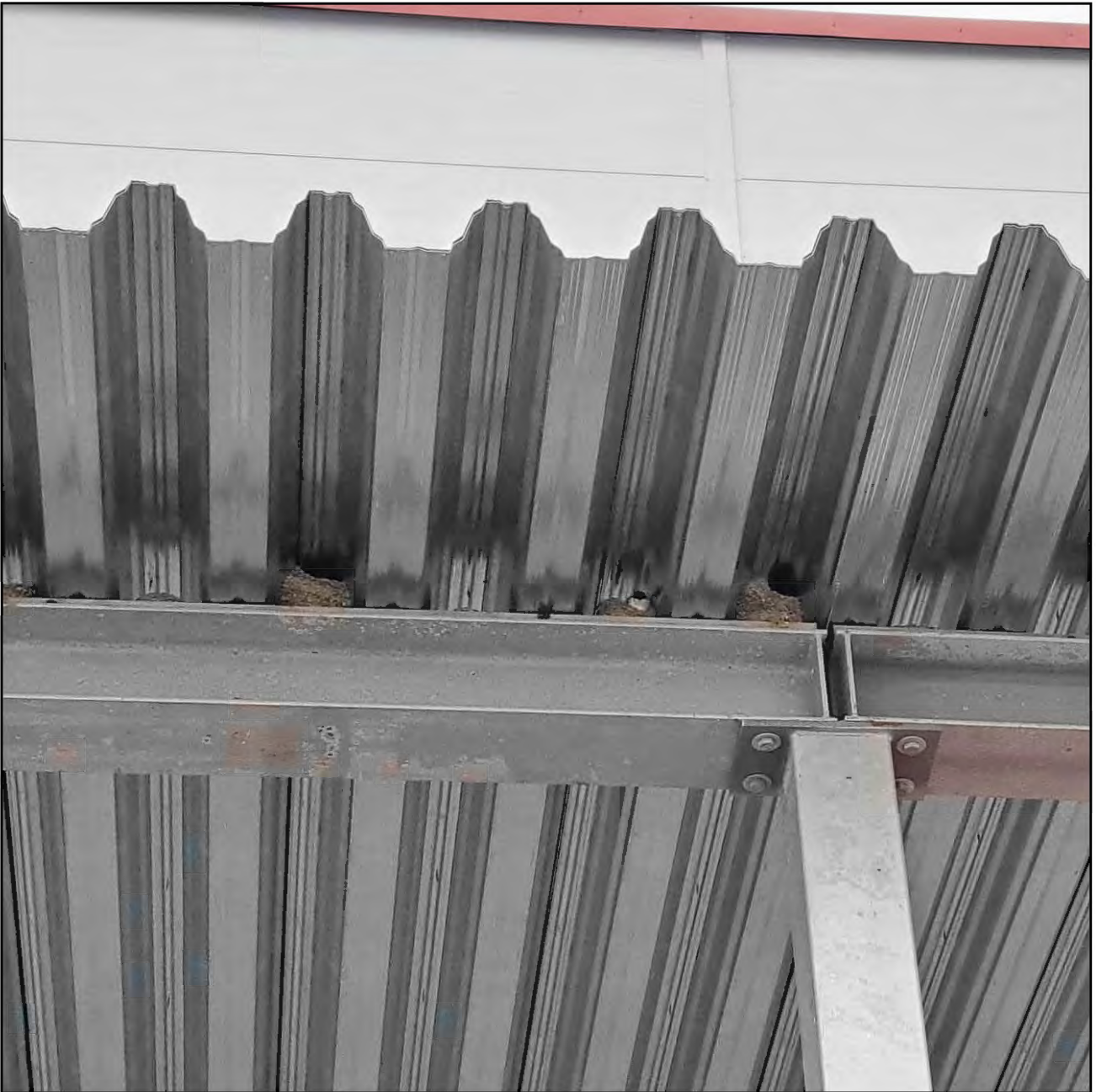
Kuva 52. Räystäspääskyn pesiä kohteella 4.2 katoksen tukipalkin päällä.
