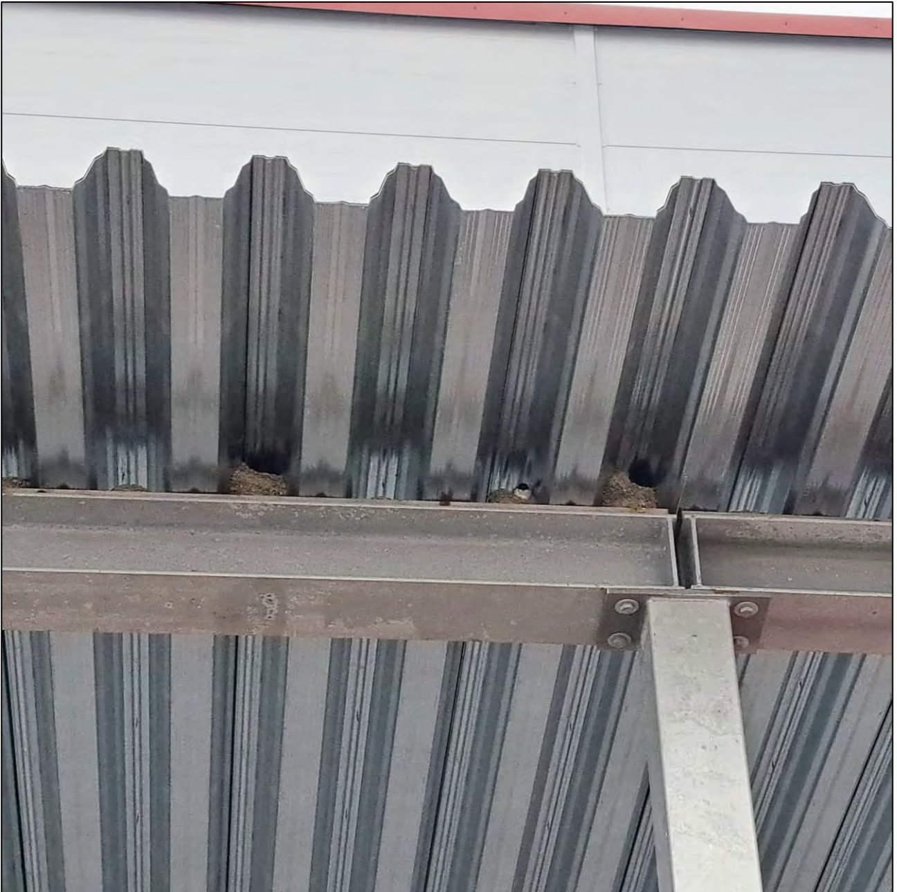
Kuva 52. Räystäspääskyn pesiä kohteella 4.2 katoksen tukipalkin päällä.
