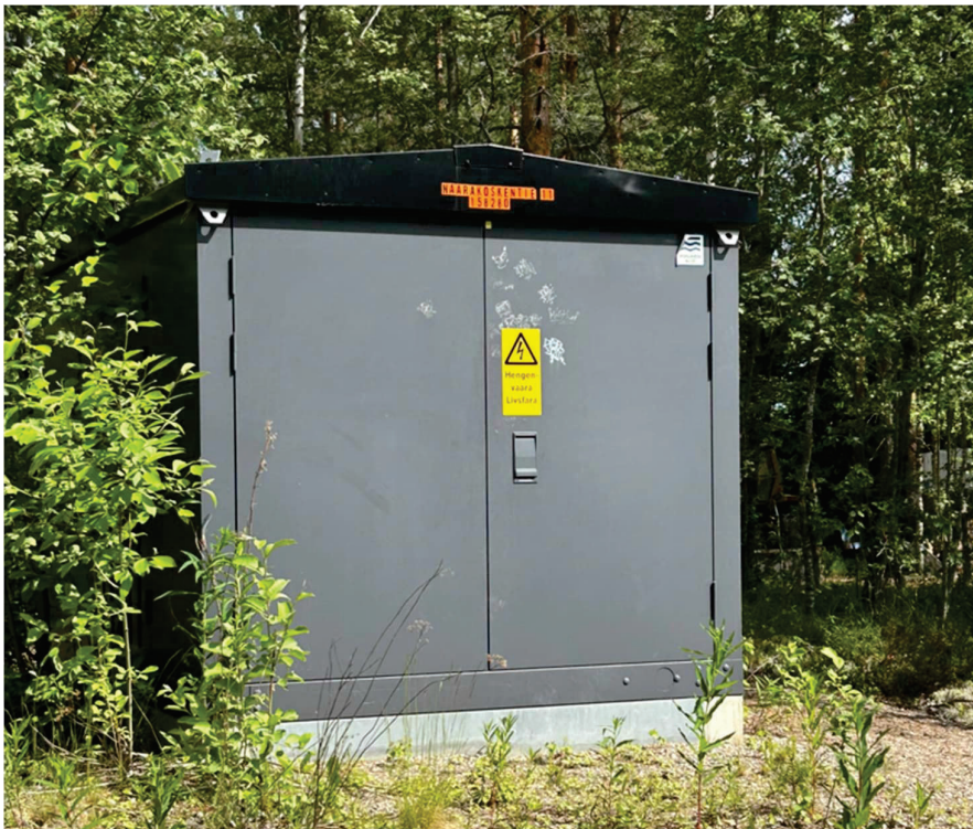
Kuva 26. Puistomuuntaja pohjavesialueen pohjoisosassa.
