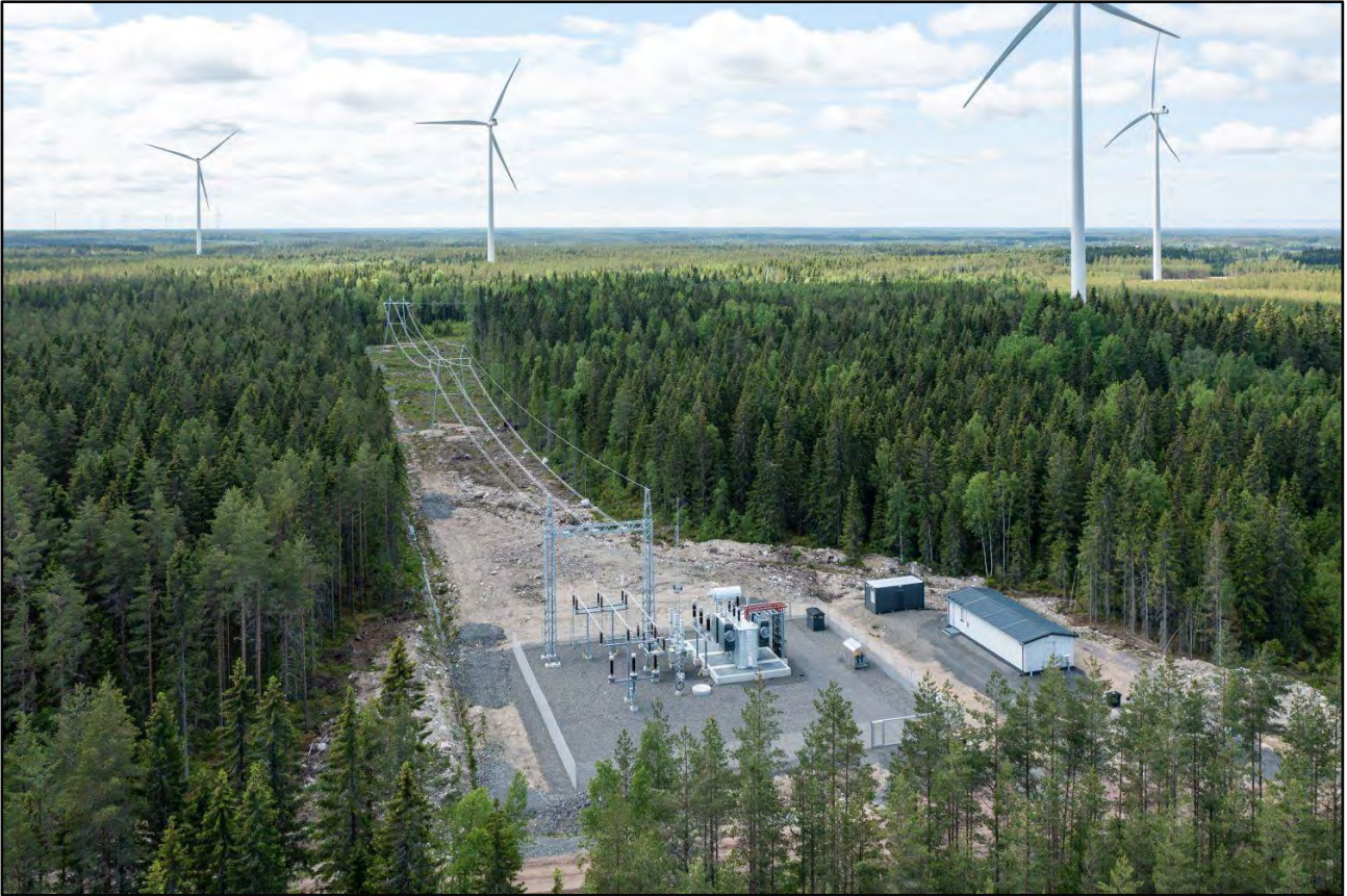
Kuva 19. Esimerkkikuva sähkönsiirrosta hankealueen sähköasemalta alkaen. Kuvan sähkönsiirto 400 kV voimajohdolla, Miilukankaan hankkeessa suunnitellaan 110 kV voimajohtoa.
