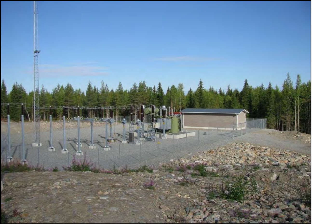
Kuva 17. Esimerkkikuva sähköasemasta. Kuvan sähköasemalla ei akkuvarastoa (Myrsky Energia Oy).
