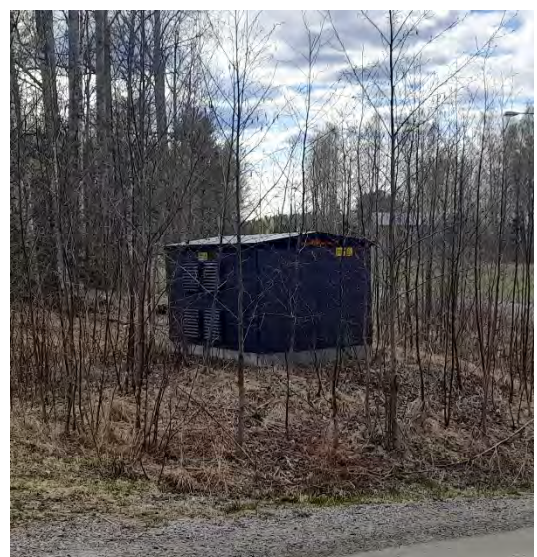
Kuva 25. Koivistonkyläntien ja koulun liittymän vierellä on sähkömuuntaja.
