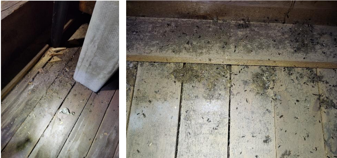
Kuva 6-5. Lepakoiden ulostepapanoita ja hyönteisjäämiä vanhan asemarakennuksen ullakkotilassa vuonna 2024.
